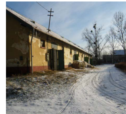
11. ábra Istállóépület - vakolatkárok (Forrás: saját felvétel)
